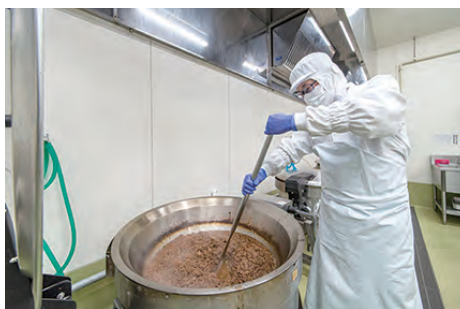
厨房 (回転釜 4台)
